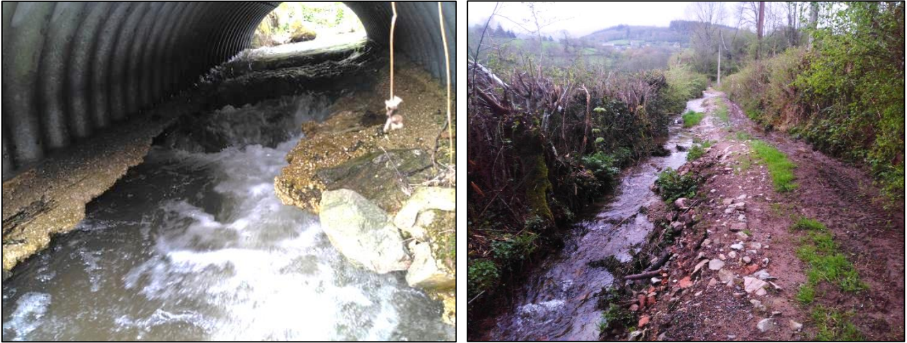
Figure 40. A gauche, érosion anormale de l'arche menaçant de tomber ; A droite, ruisseau dans un chemin rendant le passage difficile et impactant la ressource - JR
